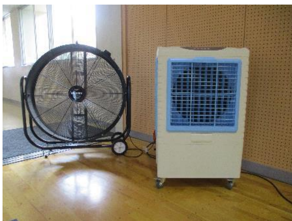
大型扇風機とスポットクーラー（体育館）
