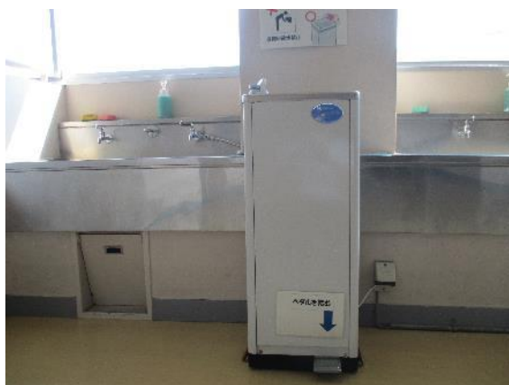
冷水機（体育館付近）
