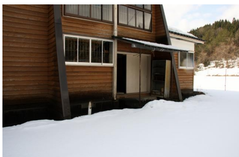
体育館の戸が内側に倒れていました。
