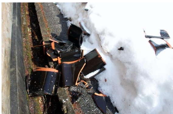
屋根瓦が落ちていました。
