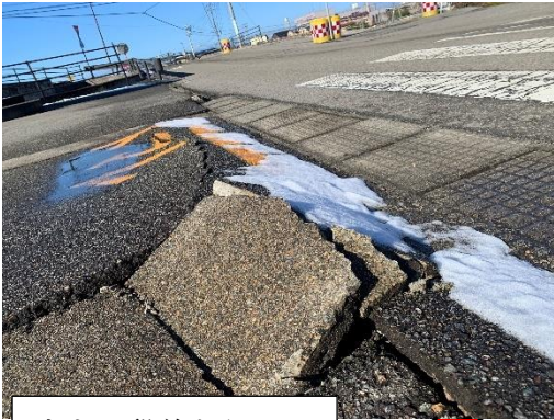
大きな段差あり
